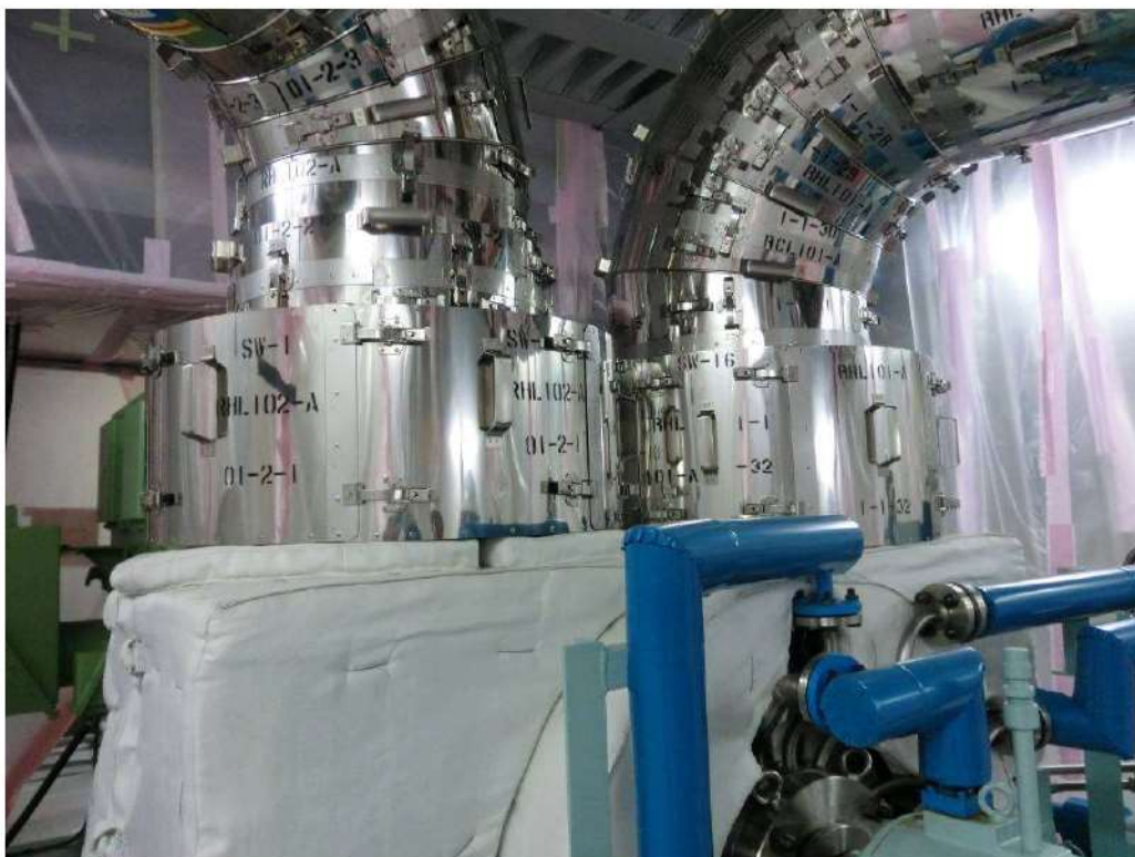
余熱除去ポンプ 配管周辺部
