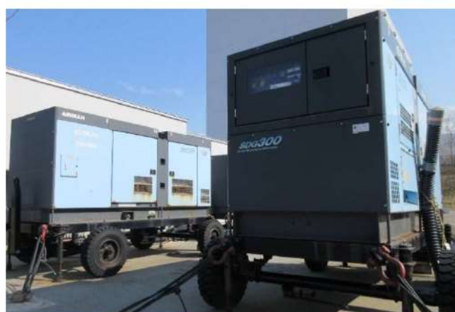
図4-11 緊急時対策所用発電機 外観
