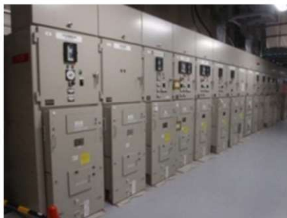
第 1-26 図：3A-安全補機開閉器室の状況
