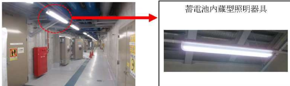
第 1-19 図：消火用非常用照明の概要
