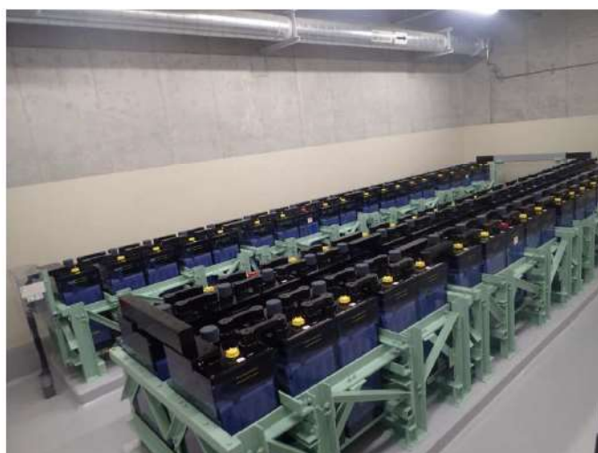
第 1-27 図：安全系蓄電池室の状況
