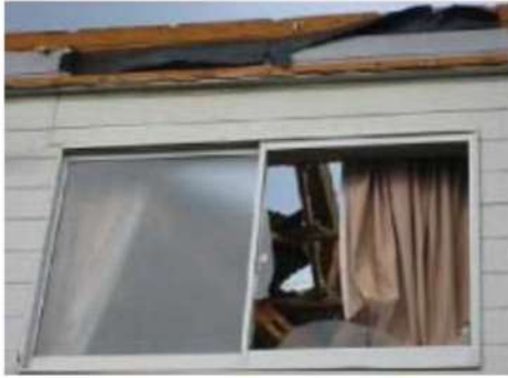
窓ガラスの損壊
