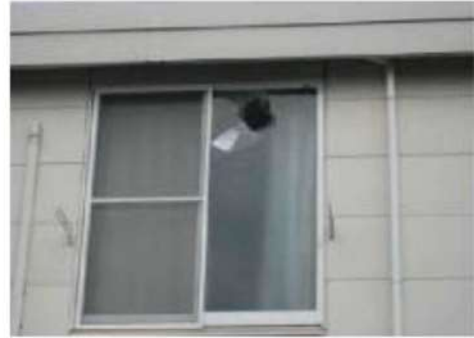
窓ガラスの飛来物衝突痕
