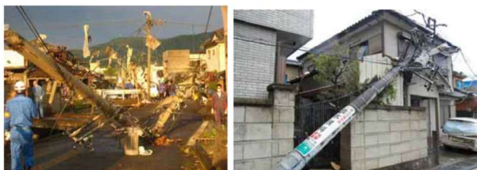
(電柱の折損, 傾斜)
