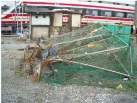
フェンスの著しい変形
