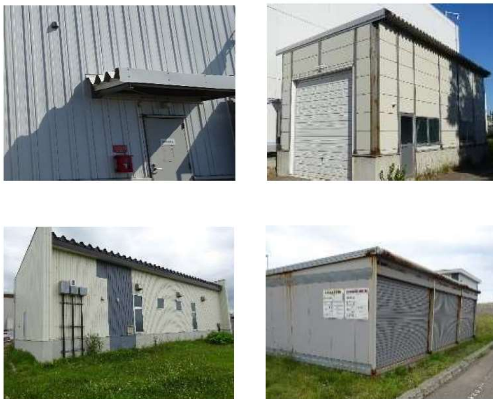
図18 泊発電所における屋外屋根の状況
