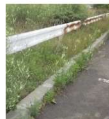
ガードレール
