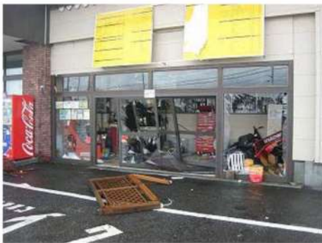
エントランスのガラス破損
