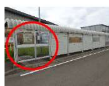
ポリカーボネート窓, 屋根
