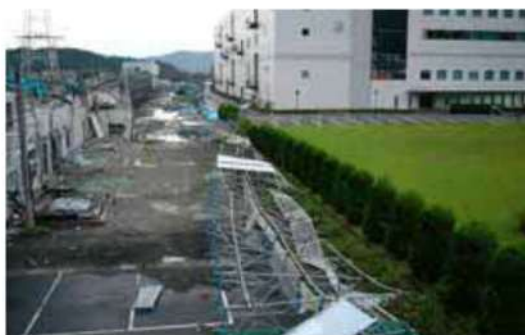
仮設足場の倒壊
