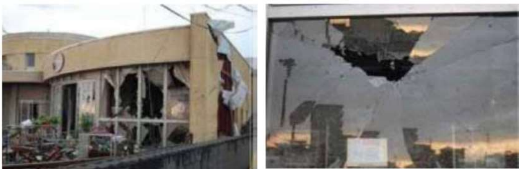
店舗の窓ガラスの被害状況
