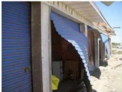
シャッターの被害
