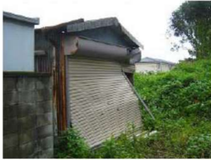
シャッターの外れ
