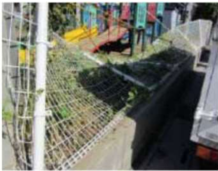
フェンスの倒壊
