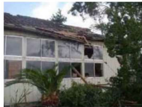
倉庫の窓ガラスと屋根の被害状況
