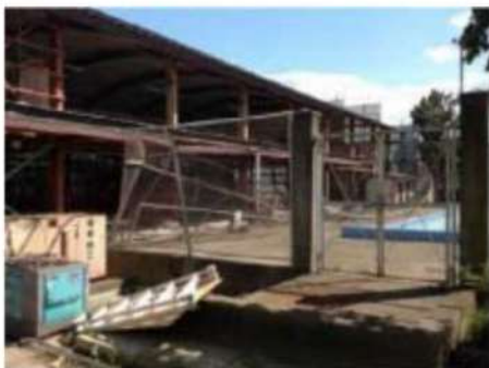
フェンスの被害（工事中の建築物）
