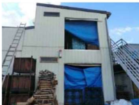
シャッターの被害
