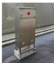
消火栓（ホース格納箱）
