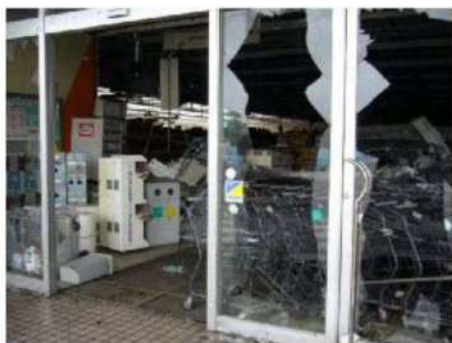
エントランスの窓ガラスの破損
