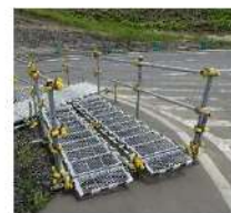
階段（単管パイプ製）
