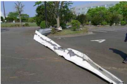
飛散した鋼板製屋根材
