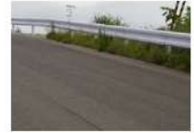
ガードレール
