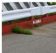
ガードレール
