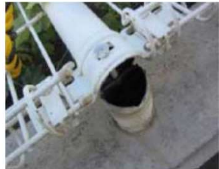
支柱部の破断
