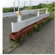
ガードレール
