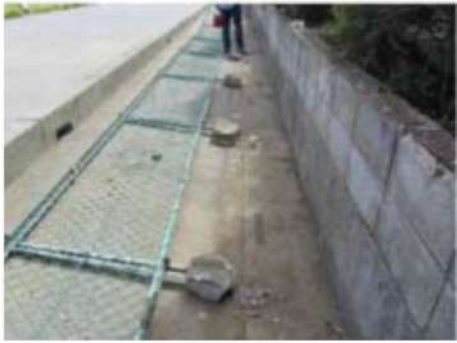
フェンスの倒壊
