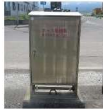
消火栓（ホース格納箱）
