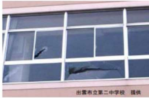
体育館窓ガラスの破損
