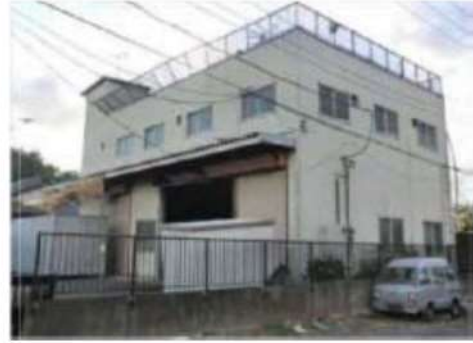
屋上フェンスの被害
