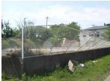
フェンスの被害状況
