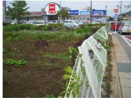
フェンスの変形
