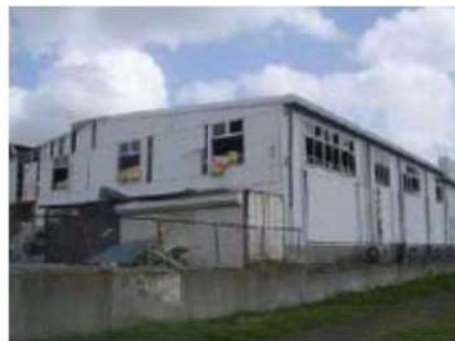
窓ガラスの破損
