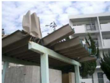
屋外トイレ屋根の損傷
