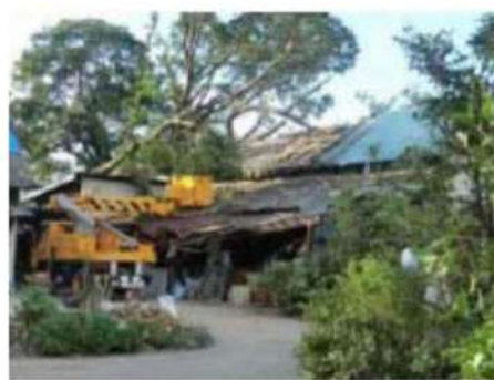
樹木の倒壊による小屋組の被害
