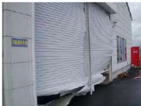
シャッターの破損
