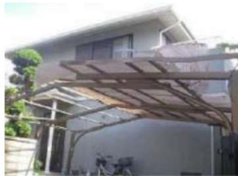
カーポートの被害
