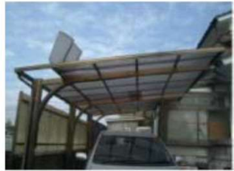
カーポート屋根の破損
