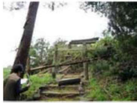
倒木の折損と鳥居の被害
