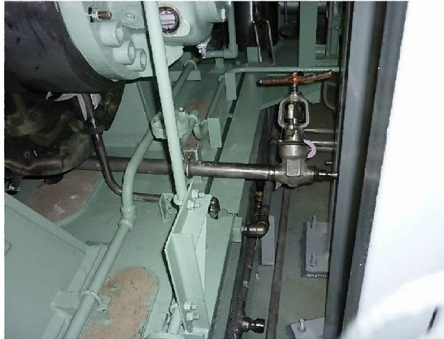
図18-3 4A, 4B余熱除去ポンプ 漏洩拡大防止措置
