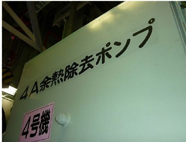
図18-1 4A, 4B余熱除去ポンプ 機器名表示
