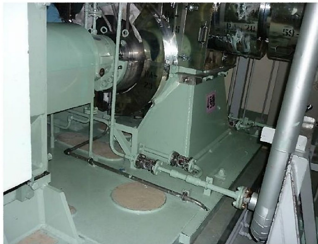
図18-2 4A, 4B余熱除去ポンプ 外観
