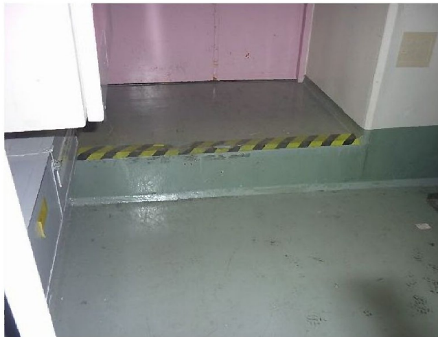
図18-4 4A, 4B余熱除去ポンプ 部屋入口の痕
