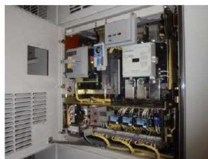
パワーコントロールセンタ
