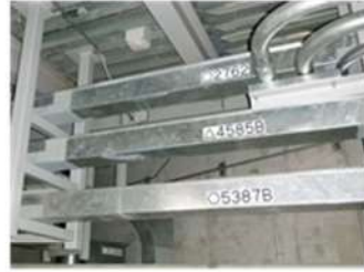
ケーブルトレイ，電線管の例
