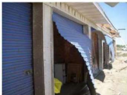
シャッターの被害
