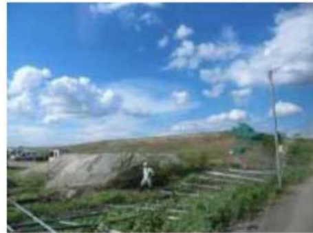
フェンスの被害
