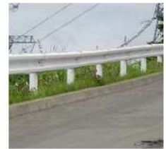
ガードレール
