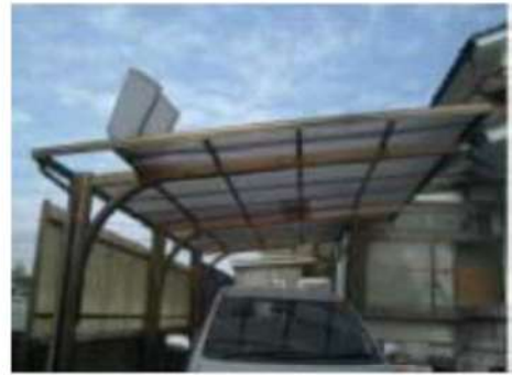
カーポート屋根の破損
