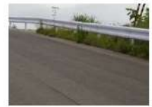
ガードレール
