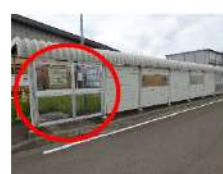
ポリカーボネート窓, 屋根
