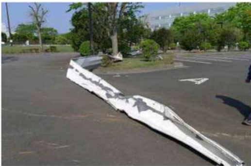
飛散した鋼板製屋根材
