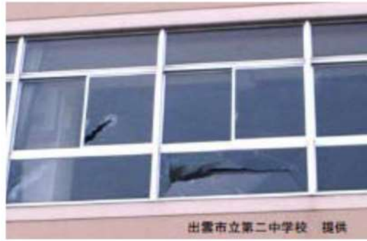
体育館窓ガラスの破損
