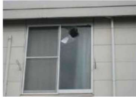
窓ガラスの飛来物衝突痕
