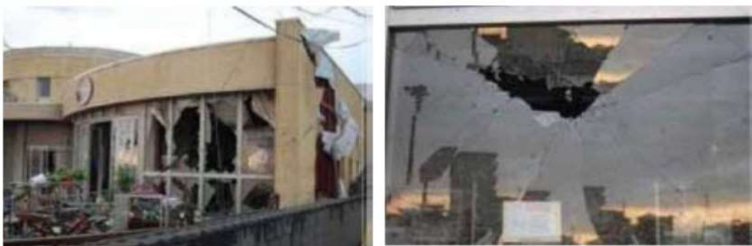
店舗の窓ガラスの被害状況
