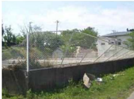
フェンスの被害状況
