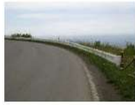
ガードレール
