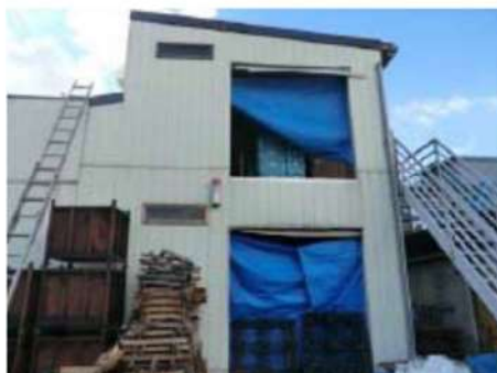
シャッターの被害
