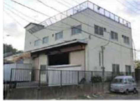
屋上フェンスの被害
