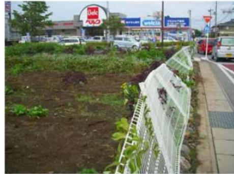
フェンスの変形
