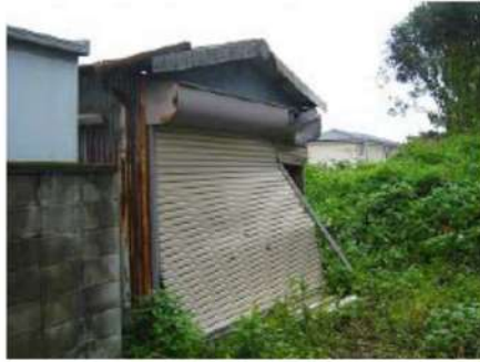
シャッターの外れ
