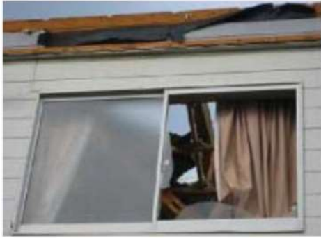
窓ガラスの損壊
