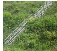
階段（単管パイプ製）
