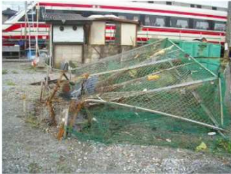
フェンスの著しい変形
