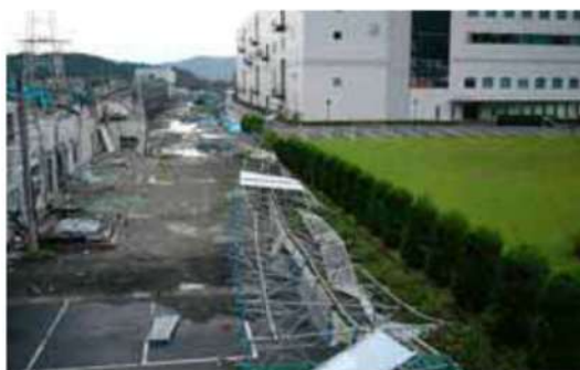
仮設足場の倒壊
