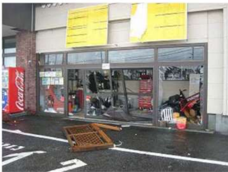
エントランスのガラス破損
