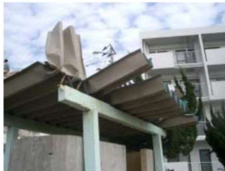
屋外トイレ屋根の損傷
