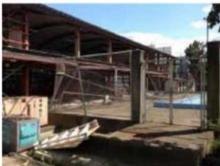
フェンスの被害（工事中の建築物）
