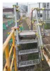
階段（単管パイプ製）
