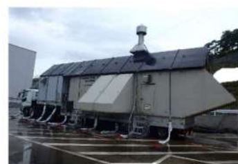
代替非常用発電機
