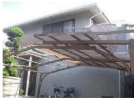
カーポートの被害
