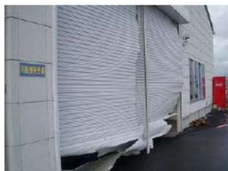
シャッターの破損
