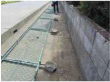
フェンスの倒壊
