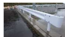
ガードレール
