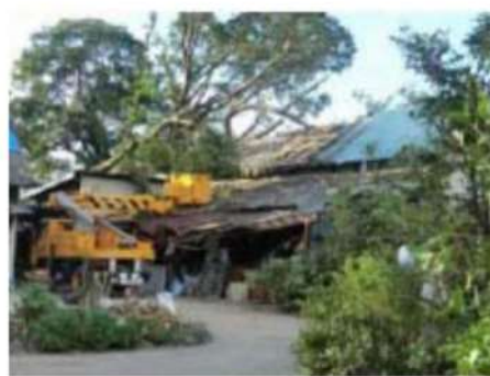
樹木の倒壊による小屋組の被害
