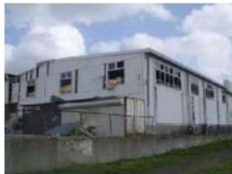
窓ガラスの破損
