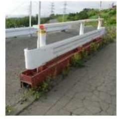
ガードレール
