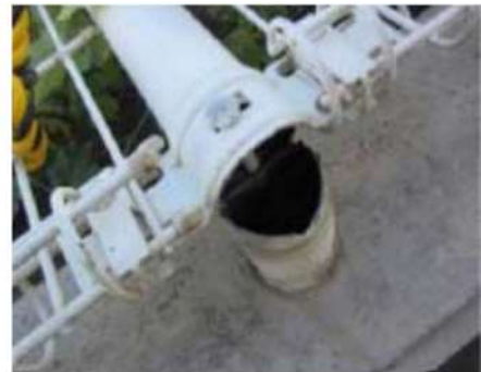
支柱部の破断
