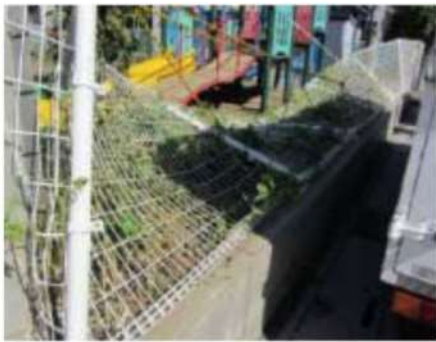
フェンスの倒壊
