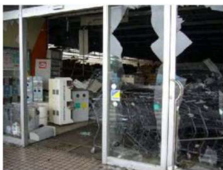
エントランスの窓ガラスの破損
