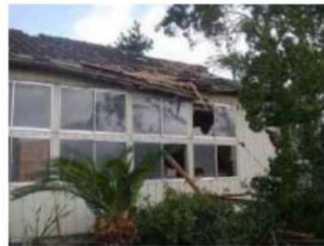
倉庫の窓ガラスと屋根の被害状況
