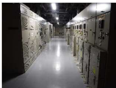
【図1 3B-安全補機開閉器室】
