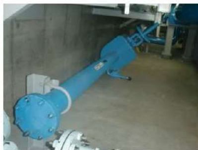
【図3 原子炉補機冷却水系統の可搬型ホース接続口】
