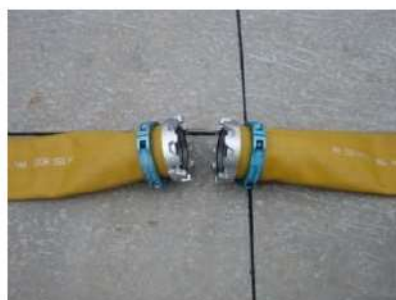
【図2 可搬型ホース接続】
