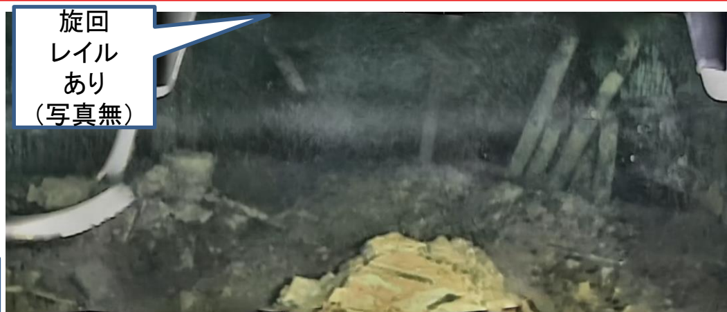
写真1. 1号機のペDESTAL内の状況
