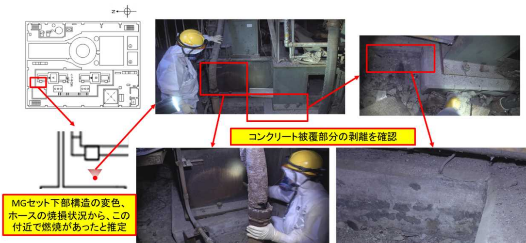
MGセット(A)の西側（下部構造及びコンクリート基礎）の状況
