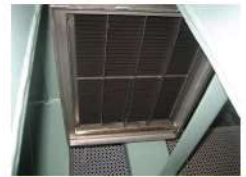
装置底部 (PAR入口吸気口)
