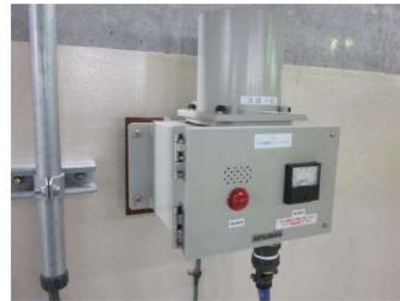
機器の固定状況
