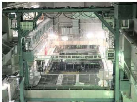
使用済燃料ピットクレーン
