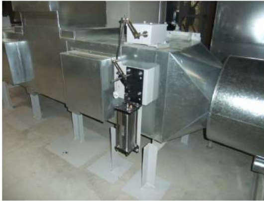
ダンパ全景 (原子炉補助建屋T.P. 24.8 m) (開操作対象ダンパの一例)
