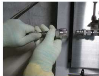
アニュラス全量排気弁等操作用可搬型窒素ガスボンベのカプラ接続 (原子炉建屋 T.P. 40. 3m)
