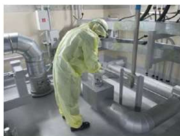
可搬型大型送水ポンプ車による 原子炉容器への注水 系統構成 （運転員（現場）B） （原子炉補助建屋 T.P. 14.5m）
