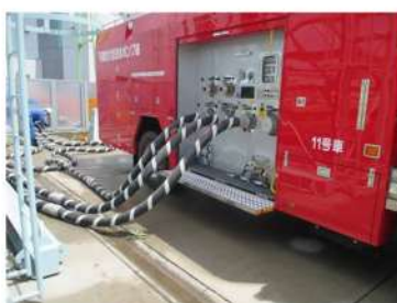
可搬型大型送水ポンプ車の設置 ポンプ車周辺のホース敷設 (屋外 T. P. 10. 3m)
