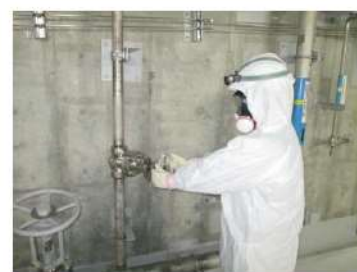
可搬型大型送水ポンプ車による 原子炉容器への注水 系統構成 （運転員（現場）C） （原子炉建屋 T.P. 10.3m）
