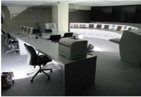
シミュレータ施設で可搬型照明（SA）を使用した状態
