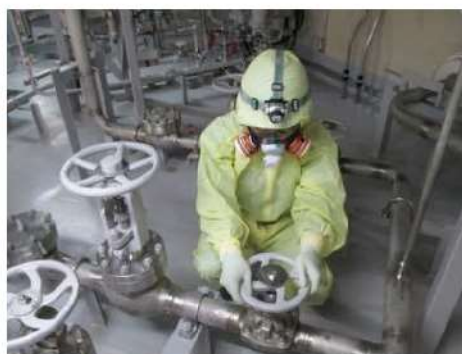
燃料取替用水ピット 補給ライン系統構成 (原子炉建屋 T. P. 21.2m)
