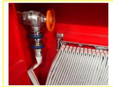
消火栓接続口 (常時接続)
