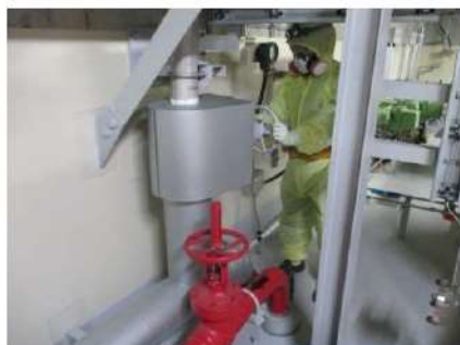
消火ポンプによる原子炉格納容器内へのスプレイ系統構成 （運転員（現場）B） （原子炉補助建屋 T.P. 10.3m）
