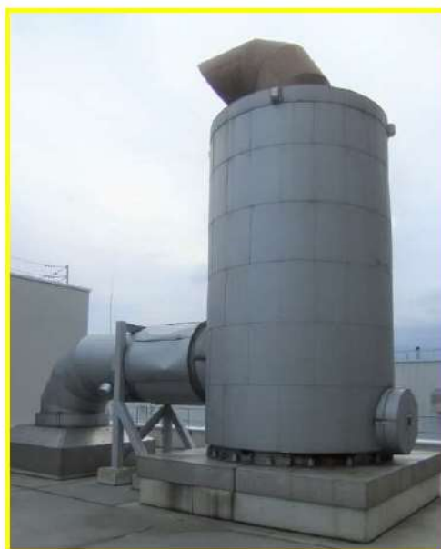
図2 ディーゼル発電機排気消音器及び排気管
