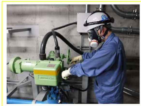
補助給水ライン流量調整 (原子炉建屋 T.P. 14. 3m)
