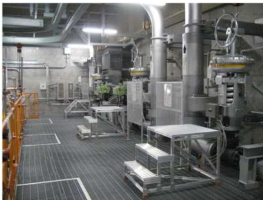
主蒸気逃がし弁設置エリア (原子炉建屋 T.P. 33. 1m)
