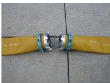
可搬型ホース（150A）接続前
