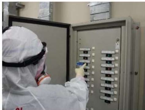
加圧器補助スプレイ弁電源入 (原子炉補助建屋 T.P. 10. 3m)
