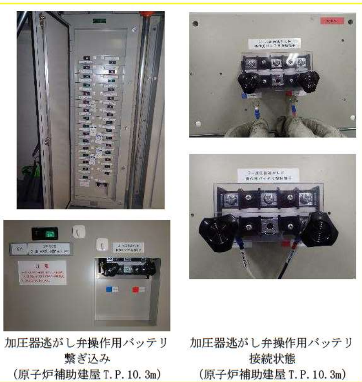
加圧器逃がし弁操作用バッテリー (原子炉補助建屋 T. P. 10. 3m)
