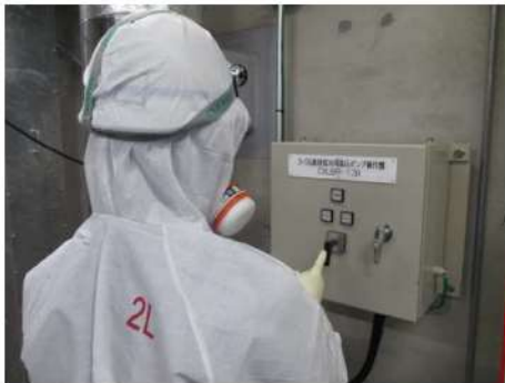
SG 直接給水用高圧ポンプ起動操作 (原子炉建屋 T.P. 24. 8m)
