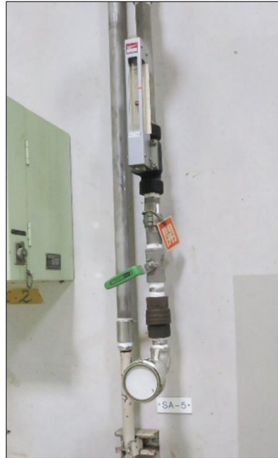
ローカルサンプリング端 管理区域内に23か所設置
