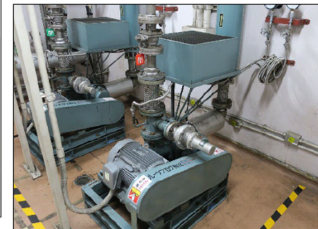
ルーツブロウ 管理区域内の空気を吸引する装置
