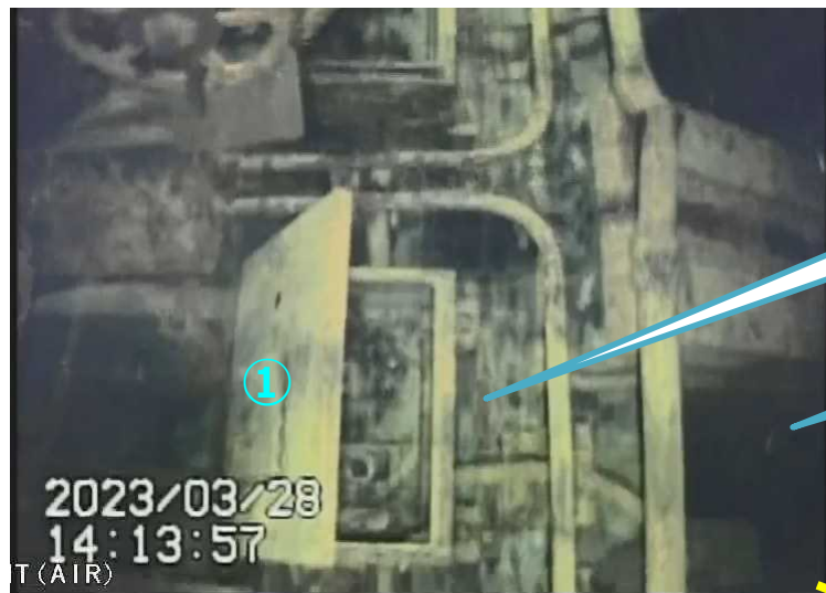
写真1.ペDESTAL開口部左上側壁面部
