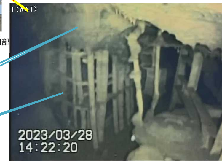
写真4.ペDESTAL開口部右下側壁面部
