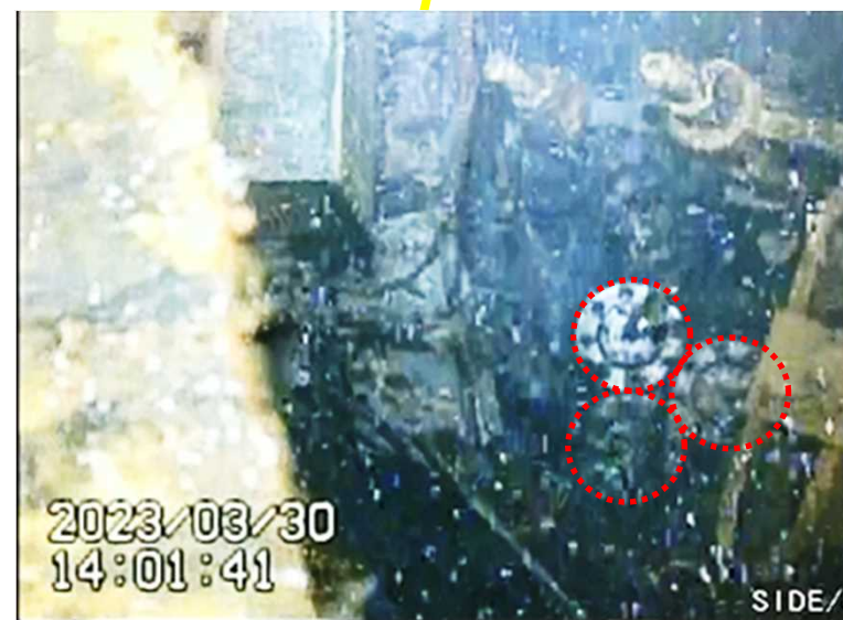
写真3 ペDESTAL壁周辺のCRDハウジングの状態 (気中)
