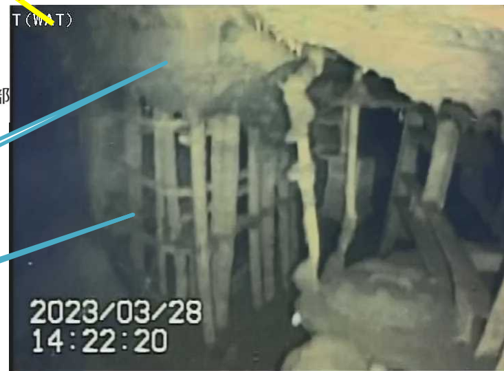
写真4.ペDESTAL開口部右下側壁面部
