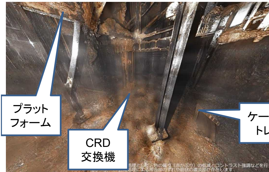
写真2. 2号機のペデスタル内の状況
