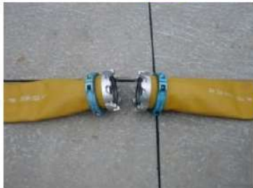
可搬型ホース（150A）接続前
