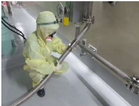
可搬型ホース接続 (原子炉補助建屋 T.P. -1.7m)
