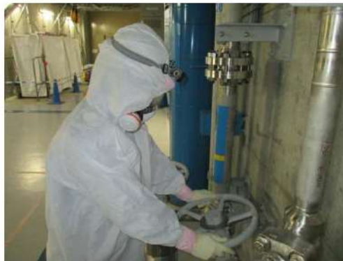
原子炉容器から原子炉格納容器への切り替え 系統構成 (原子炉建屋 T. P. 10. 3m)
