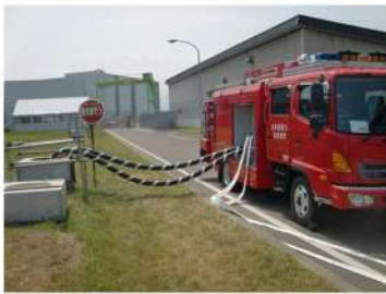
可搬型大型送水ポンプ車の設置 代替給水ピットへの吸管挿入 （屋外 T. P. 33. 1m） （作業風景は類似作業）
