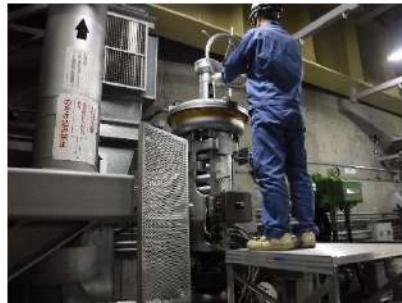
【図3 3B-主蒸気逃がし弁操作風景】
