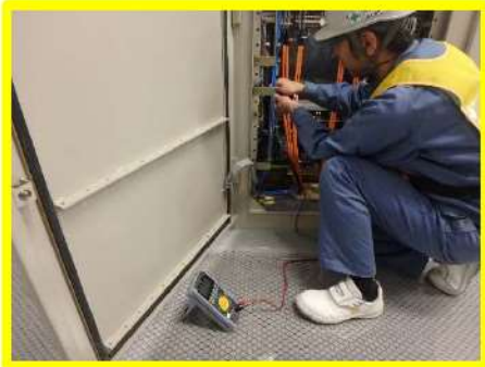
可搬型計測器接続
