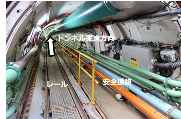
トンネル内部安全設備の整備状況
