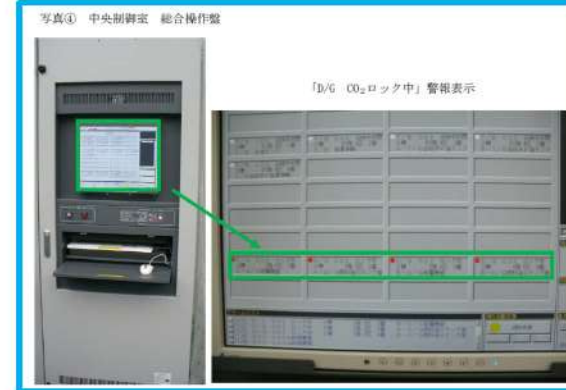
写真④ 中央制御室 総合操作盤
