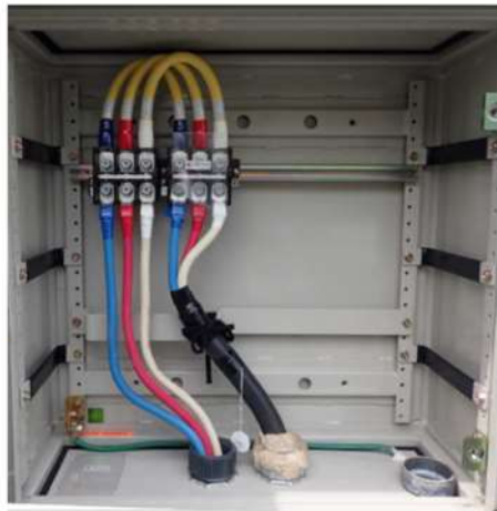
ボルト・ネジ接続 (代替直流電源)
