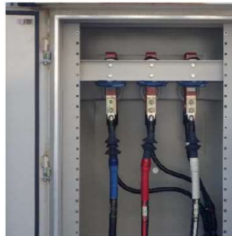
ボルト・ネジ接続 (代替交流電源)
