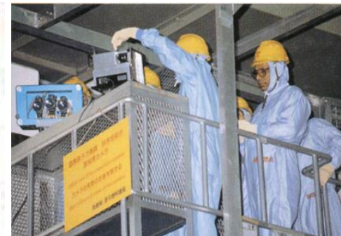
監視装置の保守管理
