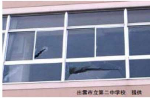
体育館窓ガラスの破損
