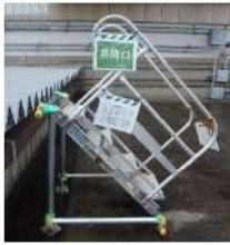
階段（単管パイプ製）
