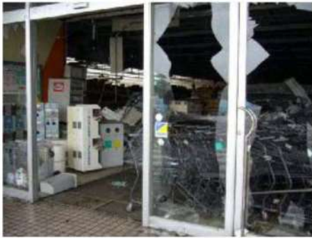
エントランスの窓ガラスの破損
