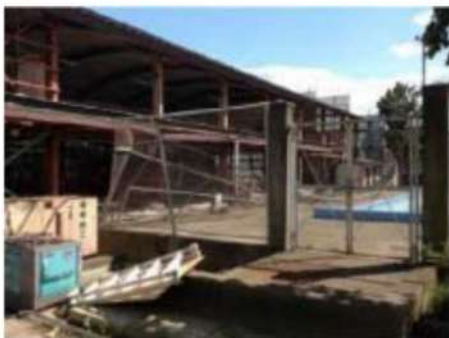
フェンスの被害（工事中の建築物）
