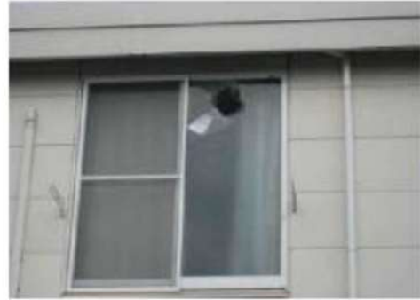
窓ガラスの飛来物衝突痕
