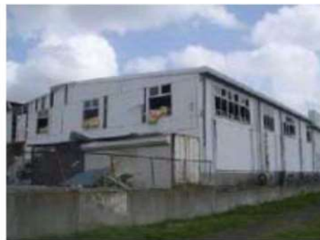
窓ガラスの破損
