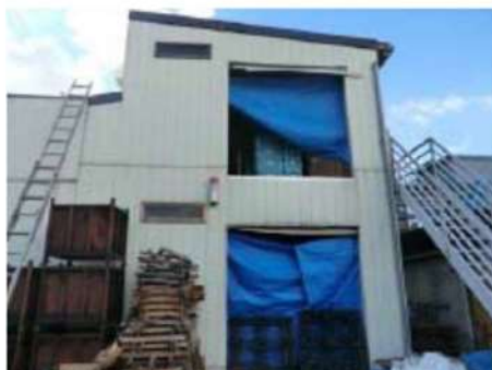
シャッターの被害
