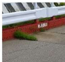
ガードレール
