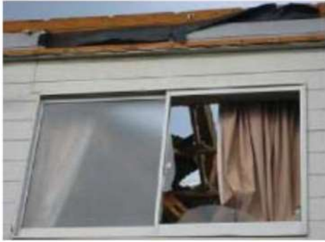
窓ガラスの損壊
