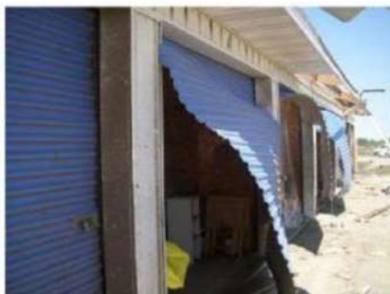
シャッターの被害
