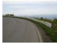
ガードレール
