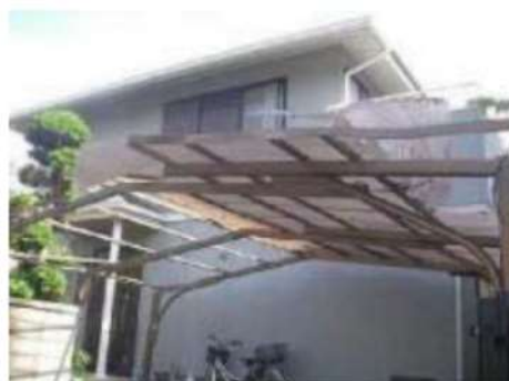
カーポートの被害
