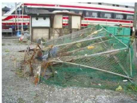
フェンスの著しい変形
