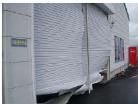
シャッターの破損
