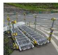
階段（単管パイプ製）
