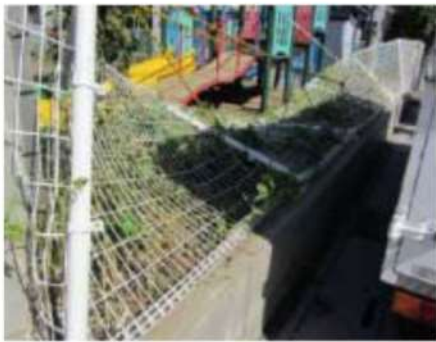
フェンスの倒壊
