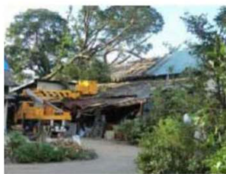
樹木の倒壊による小屋組の被害
