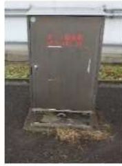
消火栓（ホース格納箱）
