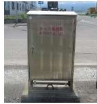
消火栓（ホース格納箱）
