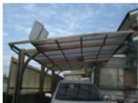
カーポート屋根の破損
