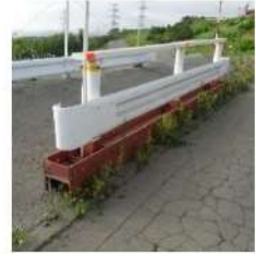
ガードレール
