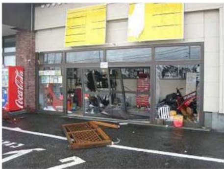
エントランスのガラス破損
