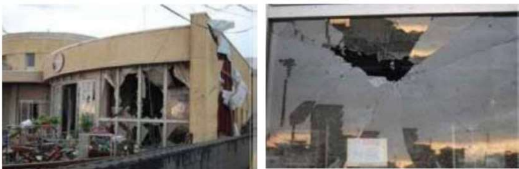
店舗の窓ガラスの被害状況
