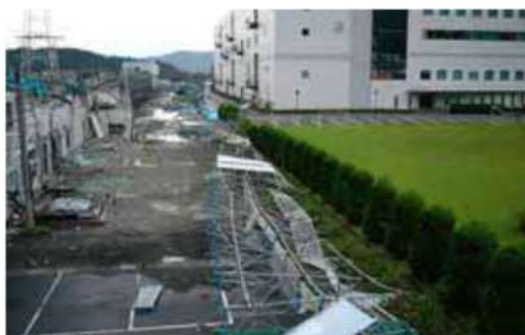
仮設足場の倒壊
