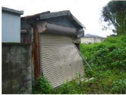
シャッターの外れ
