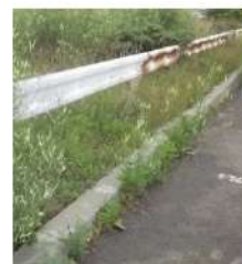
ガードレール
