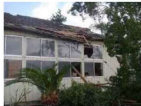
倉庫の窓ガラスと屋根の被害状況
