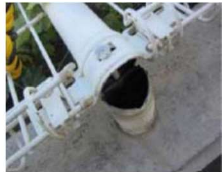
支柱部の破断
