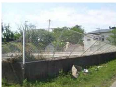
フェンスの被害状況
