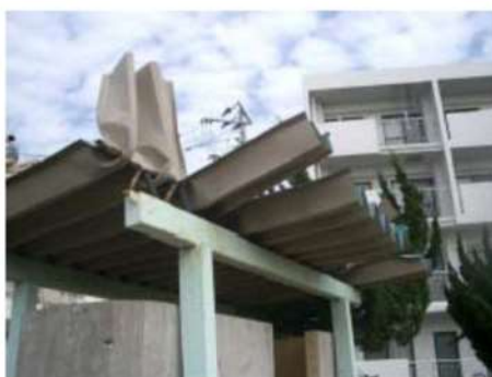
屋外トイレ屋根の損傷
