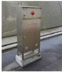
消火栓（ホース格納箱）
