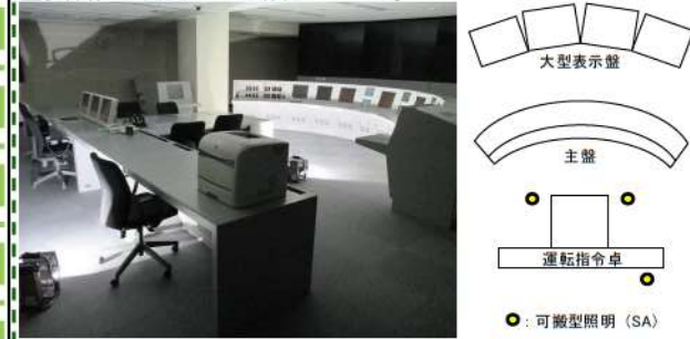
図2.5-5 シミュレータ施設における可搬型照明（SA）点灯状況
