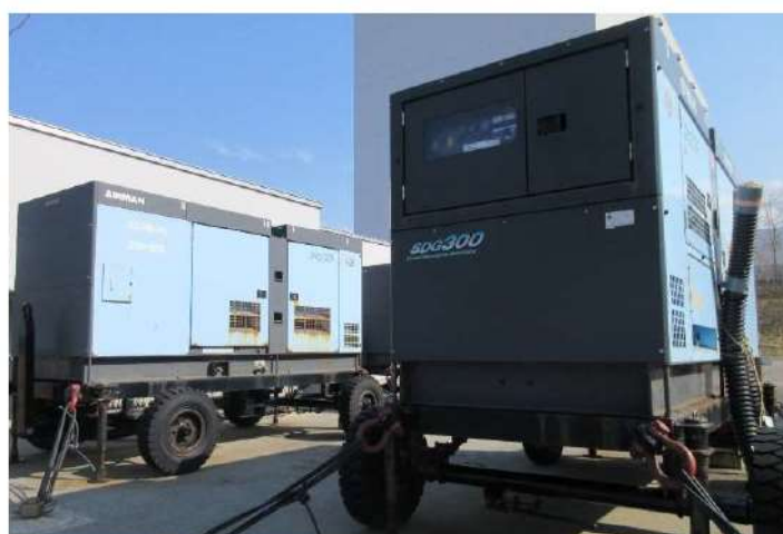
図4-11 緊急時対策所用発電機 外観
