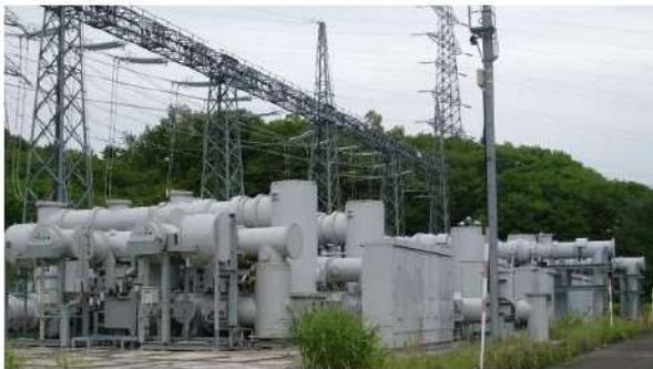
西野変電所（GIS）
