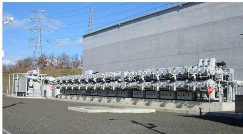
第 2.2.4.6 図 開閉所設備外観
