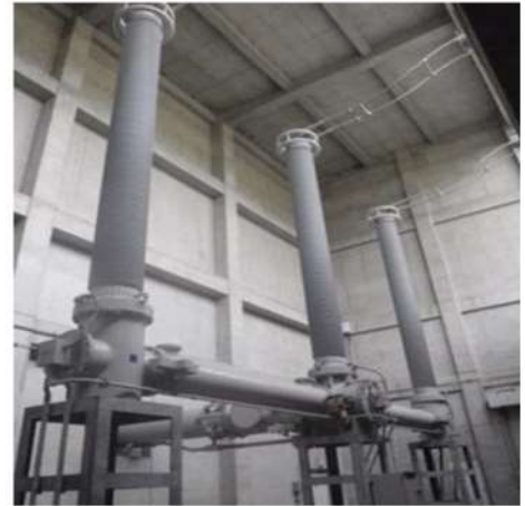
275kV ブッシング
