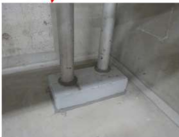
電線管貫通部
