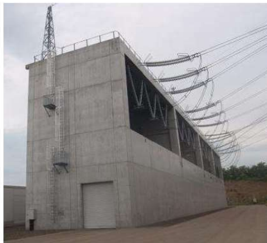
図1 開閉所（遮風建屋）
