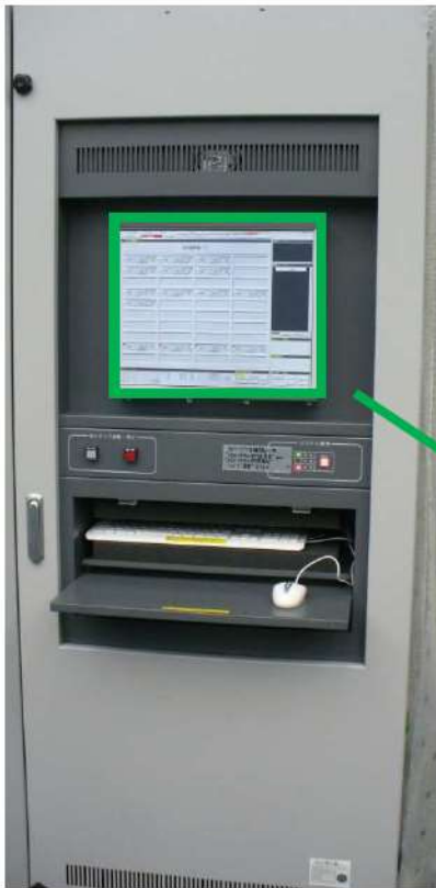
写真④ 中央制御室 総合操作盤
