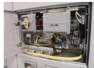
コントロールセンタ
