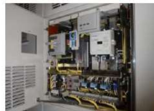
パワーコントロールセンタ
