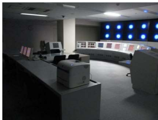
無停電運転保安灯点灯時
