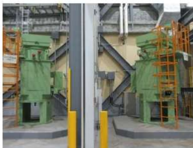
(原子炉補機冷却海水ポンプモータ予備品)
