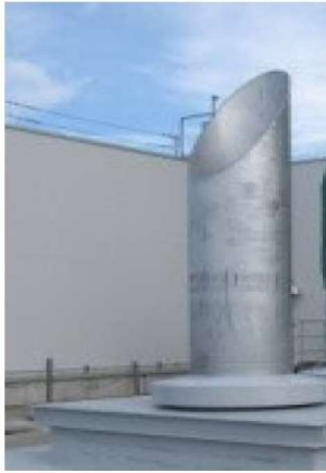
図3 主蒸気安全弁排気管の設置状況
