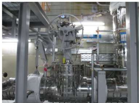
3 A-余熱除去ポンプ入口弁 (3V-RH-005A)
