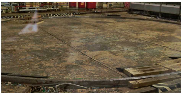
写真は、いずれも2021年12月14日に原子力規制庁撮影
