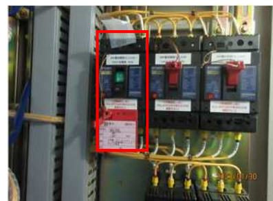
MG電源制御ユニット A主電源 NF4
