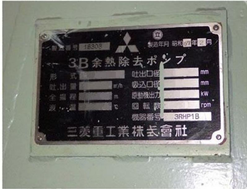
図 19-1 3A 余熱除去ポンプ, 3B 余熱除去ポンプ 銘板
