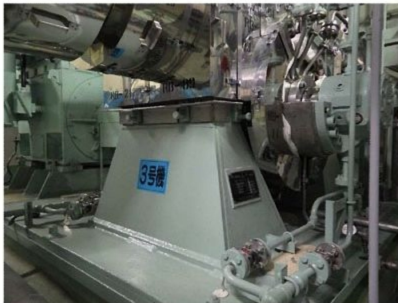
図 19-2 3A 余熱除去ポンプ, 3B 余熱除去ポンプ 機器全体
