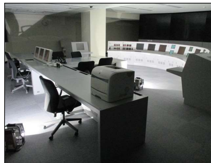
図5 シミュレータ施設における可搬型照明 (SA) 点灯状況 14
