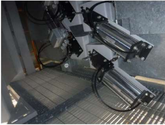
ダンパ全景 (原子炉補助建屋T.P. 40. 3m)
