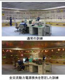
図4-5 非常灯照明下で対応操作の確認（訓練）
