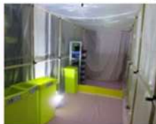
可搬型照明①
