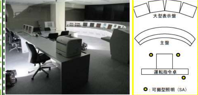
図2.5-5 シミュレータ施設における可搬型照明（SA）点灯状況
