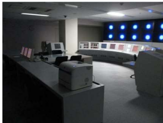
無停電運転保安灯点灯時
