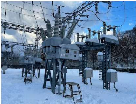
国富変電所（GCB）
