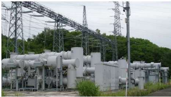
西野変電所（GIS）
