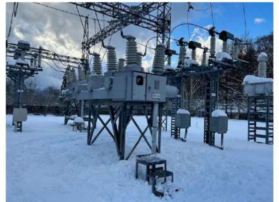
国富変電所（VCB）
